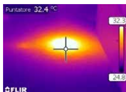
PERDITA D'ACQUA OCCULTA
