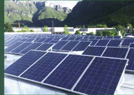
IMPIANTI INDUSTRIALI Velo d'Astico 50 kWp
